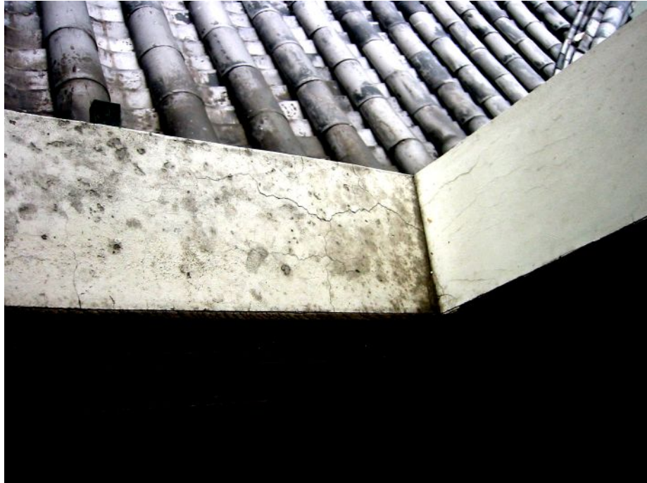
名古屋城内部の壁の割れ
